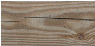
Spannungsrisse durch die Holz-trocknung
