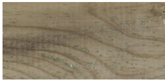
Raue Stellen auf der Holzoberfläche
