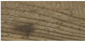
Stockflecken und leichter Schimmelbefall
